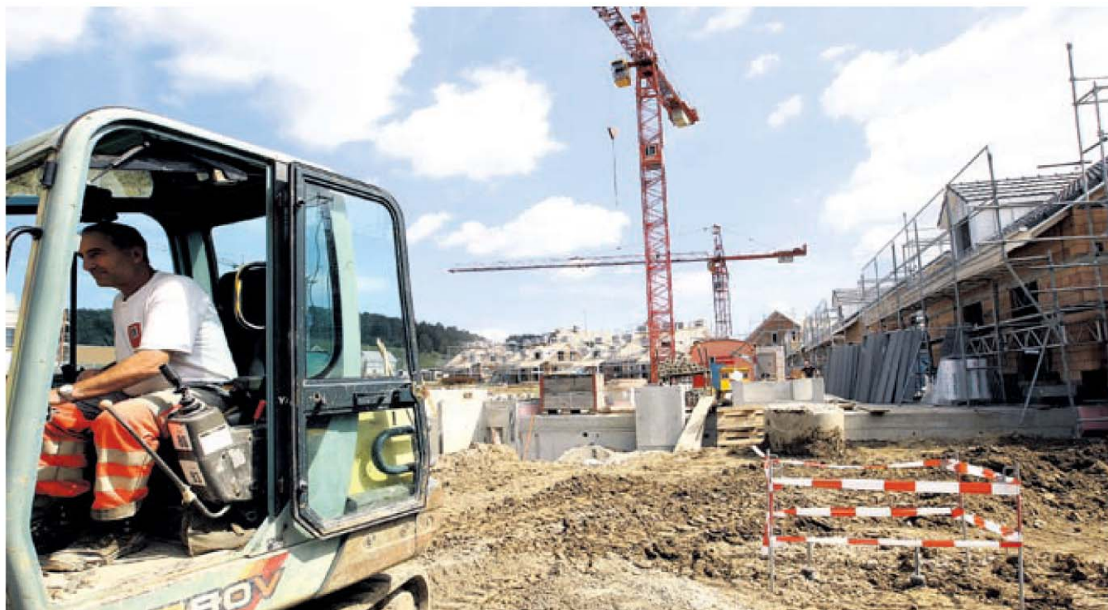
Grossbaustelle Chlimberg: Nordwestlich der Umfahrung von Neftenbach sind etwa 200 Einfamilienhäuser und Wohnungen geplant, im Bau oder schon bezogen. Bild: Moritz Hager
